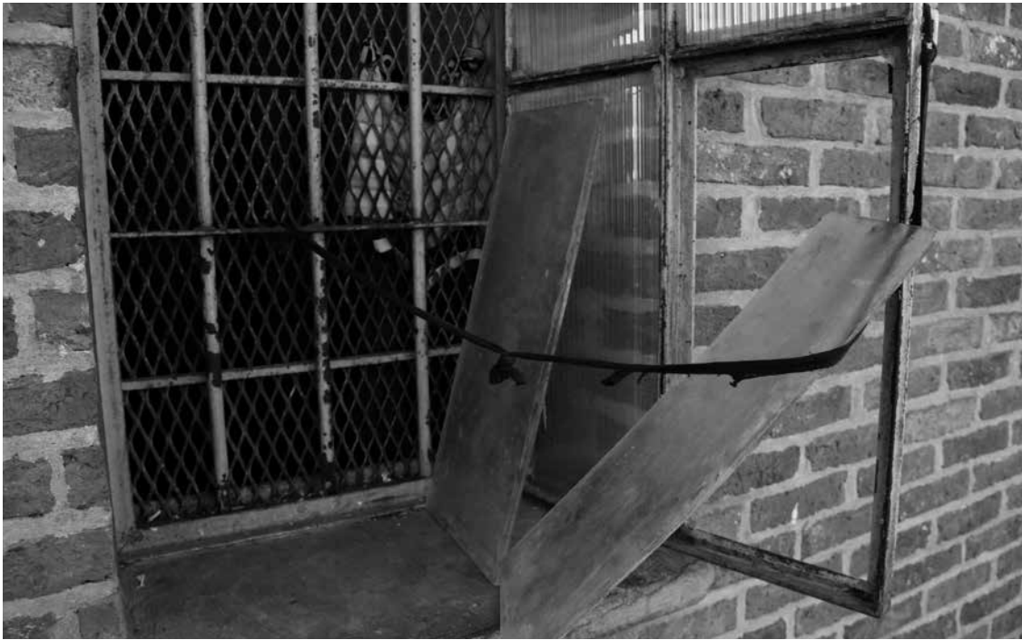
Ventanas rotas en las celdas del Centro de recepción Lomas de Zamora. 2018. Foto: archivo CPM
