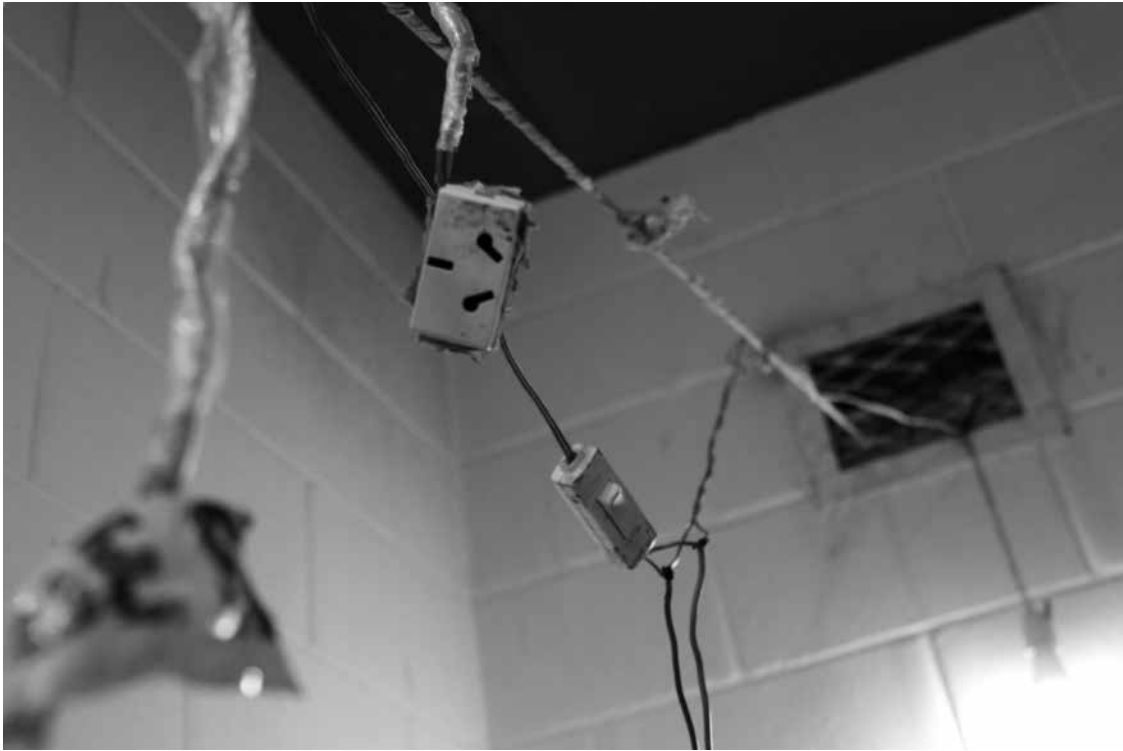
Instalaciones eléctricas precarias y riesgosas. Centro cerrado Virrey del Pino, La Matanza. 2019. Foto: archivo CPM
