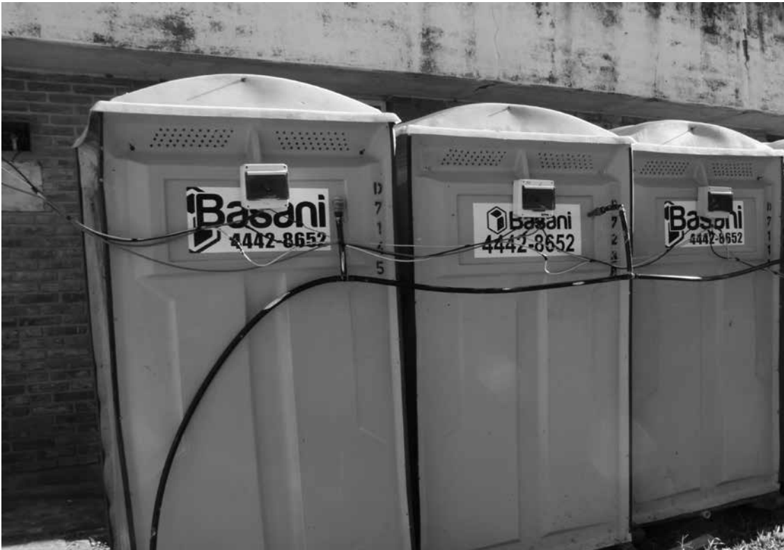
Duchas en baños químicos con conexiones eléctricas riesgosas. Instituto Araoz Alfaro, Abasto. 2018. Foto: archivo CPM
